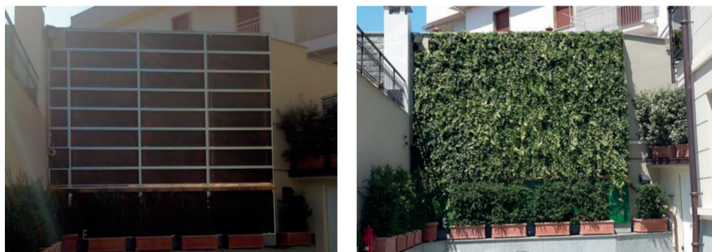
Fig. 3 – Esempio di parete realizzata dalla Growing Green (Valenza -AL, Italia). A sinistra la sottostruttura, a destra la parete vegetata, assemblata in poche ore grazie al sistema di aggancio rapido di cui sono dotati i singoli moduli.
